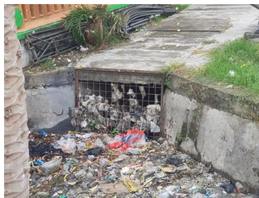
Gambar 7. Kondisi Saluran Titik 2
