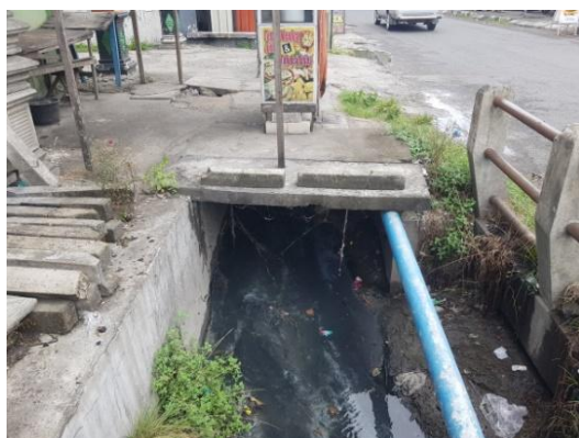
Gambar 9. Kondisi Saluran Titik 4
