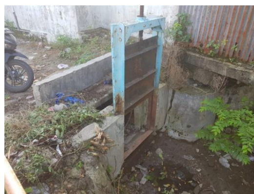
Gambar 8. Kondisi Saluran Titik 3
