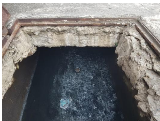
Gambar 6. Kondisi Saluran Titik 1
